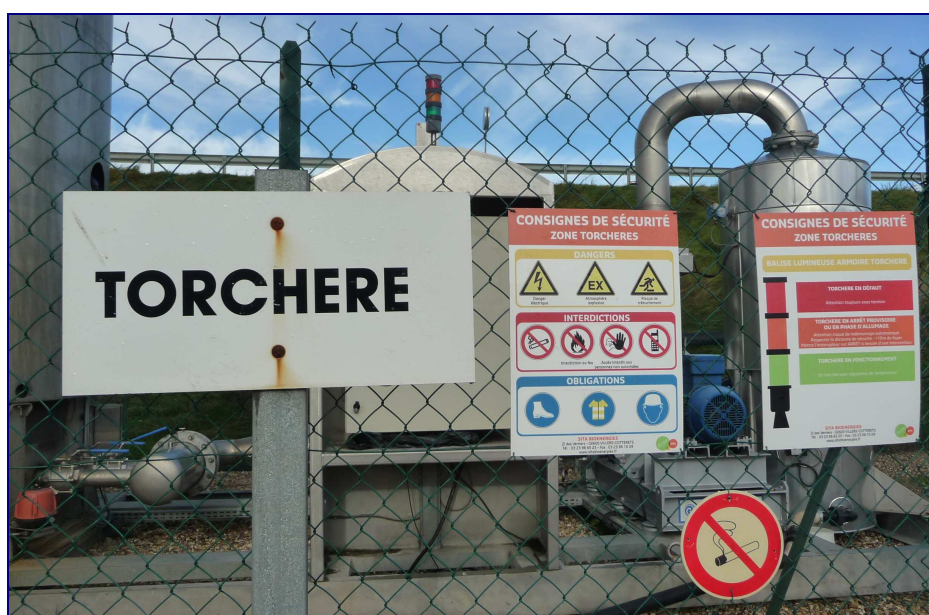
Photo 16 : Panneaux de rappel des consignes de sécurité au niveau de la torchère
